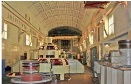
Машинный зал Нива ГЭС-3
