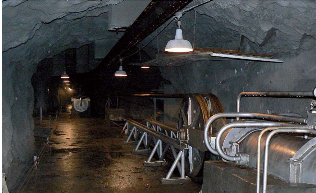
Помещение приборных турбинных затворов Борисоглебской ГЭС
